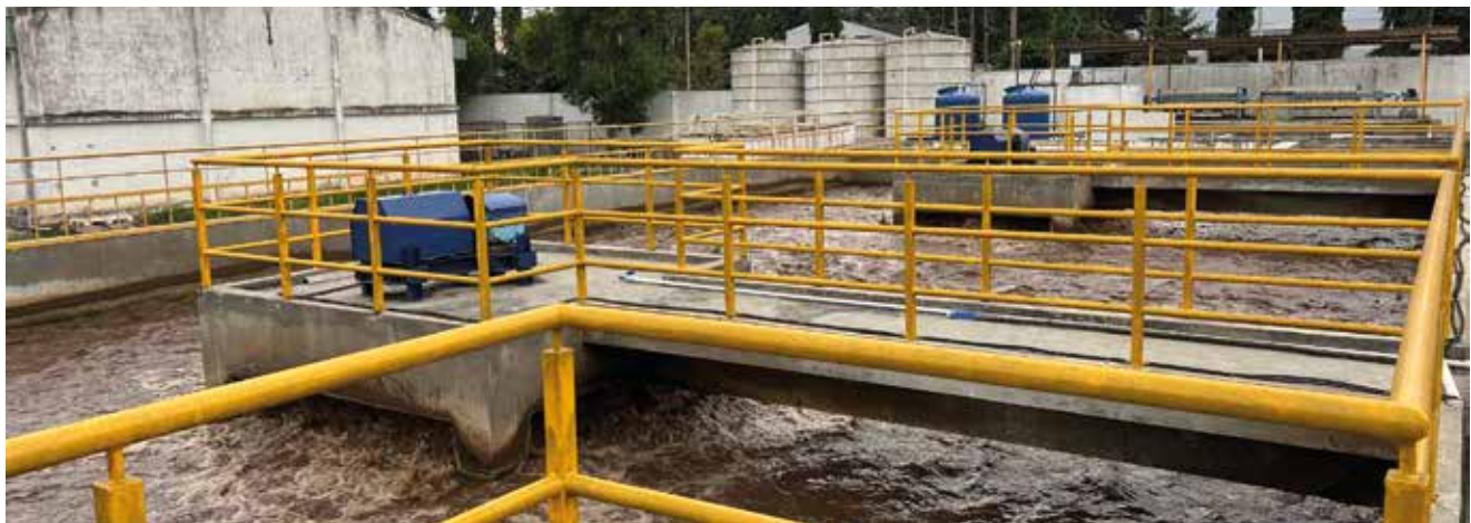
Abwasserkläranlage bei Reitzel Indien
